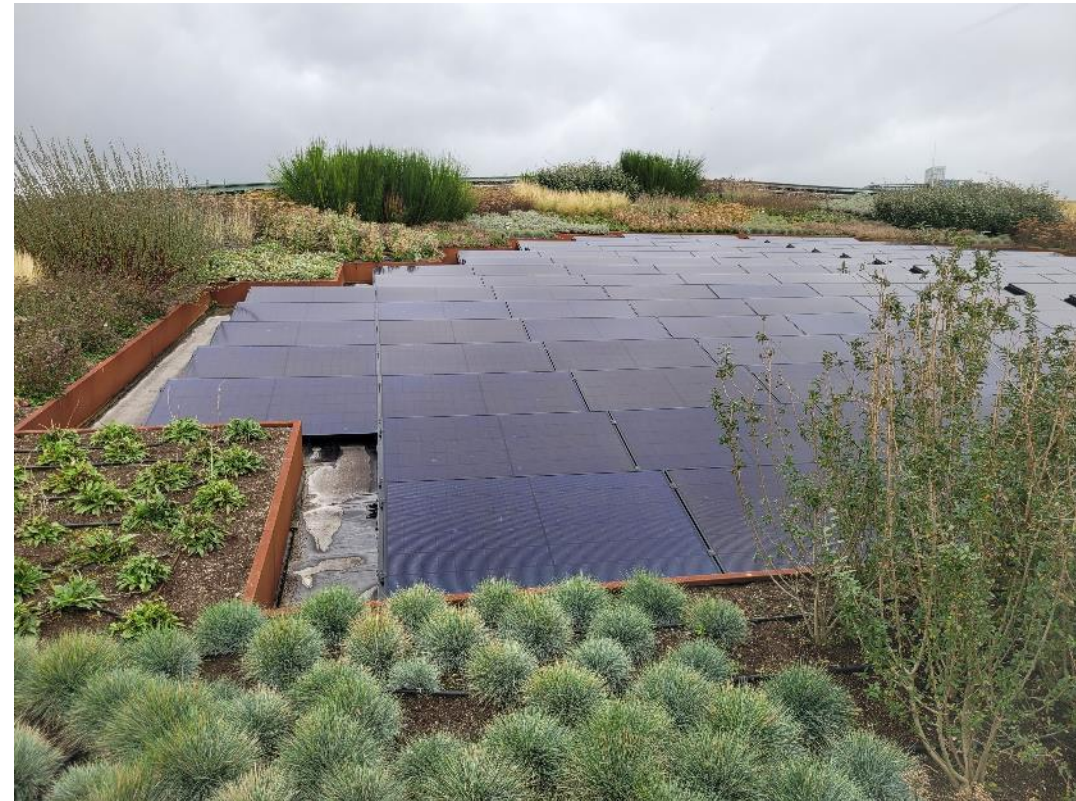
Begrüntes Dach mit PV-Anlage, © HLNUG, Kuckuk
